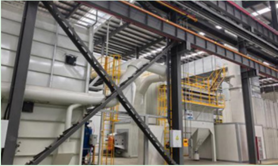
废气处理系统
